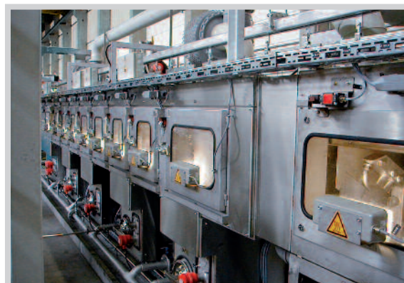
Image détaillée de l'installation à passage continue
